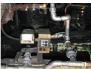
金屬工廠 大型空氣乾燥機
