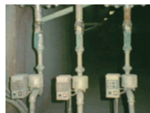
製鐵廠 末端的空氣排出裝置
