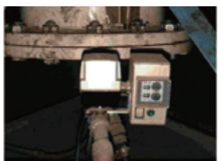
水泥廠 大型空濾水泥槽
